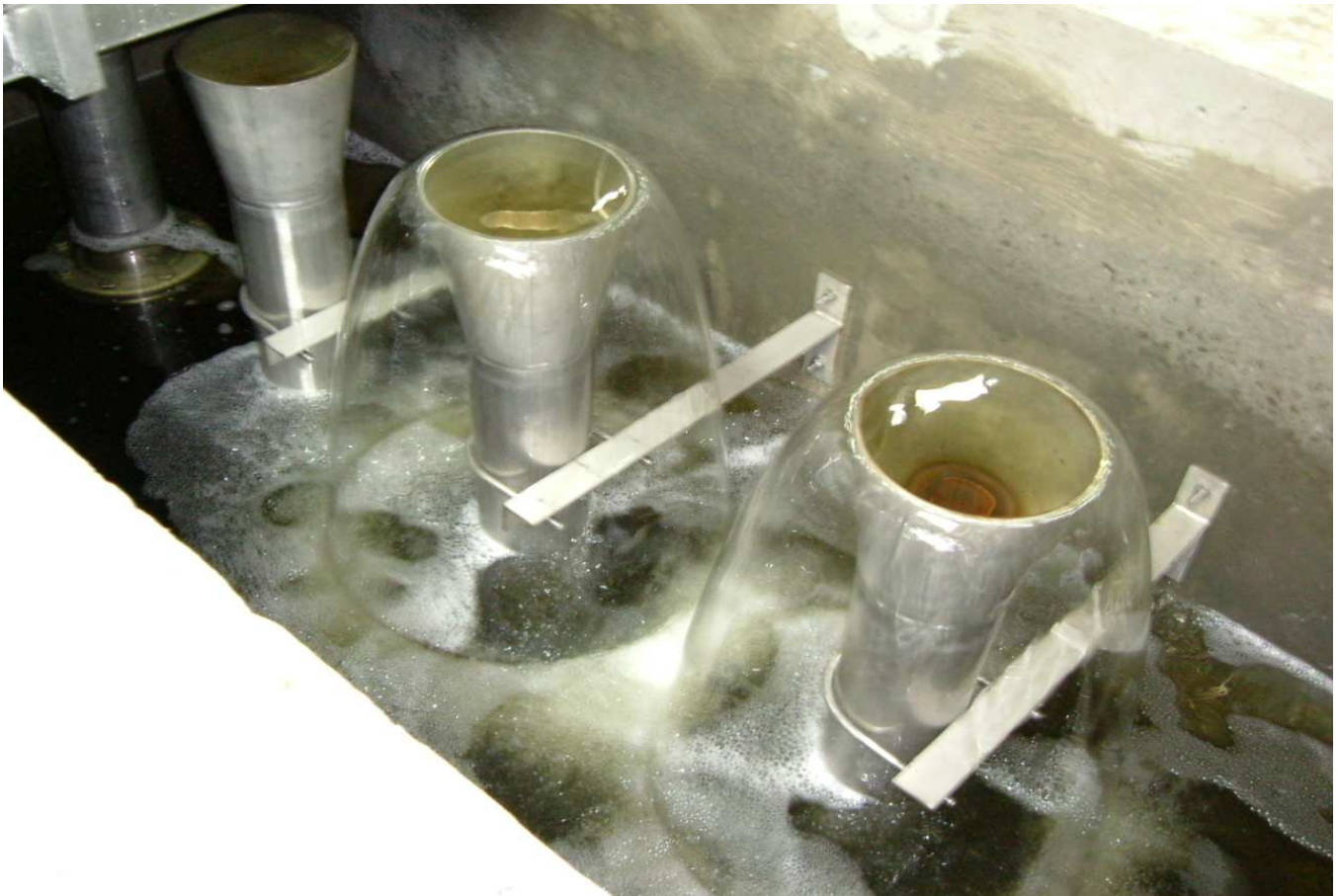
Sortie d'eau épurée
